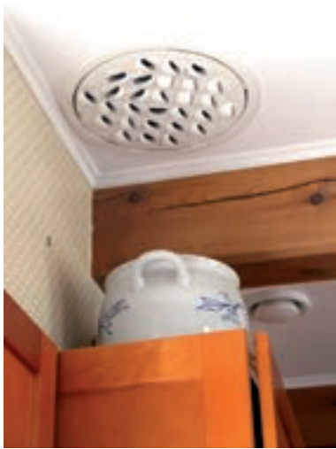
Climeconin päätelaite on keittiön katossa kuin koriste.
