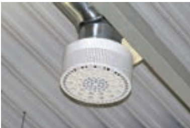
Climecon päätelaite hallin katossa välittää hyvää sisäilmaa tasaisesti.
