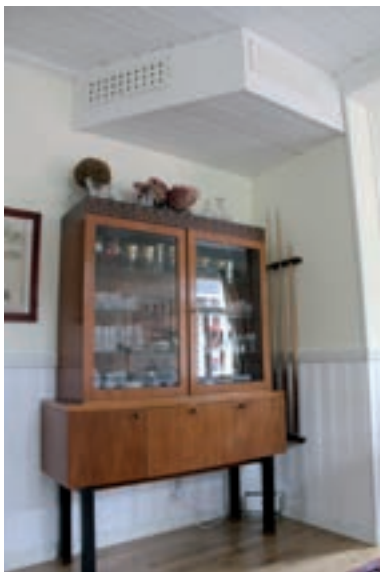
Vain yhdessä kohtaa kanava-asennuksessa jouduttiin turvautumaan kotelointiin.
