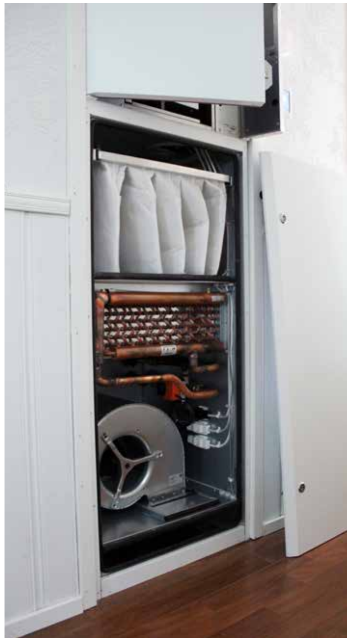
Uusi Enervent Pingvin Kotilämpö asennettuna.
